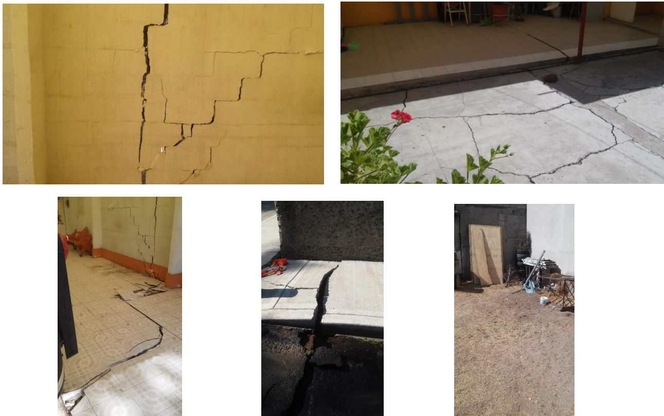
Figura 1. Características de los efectos más superficiales en viviendas, dentro de la zona crítica afectadas por grietas y fracturas registradas en la zona.
